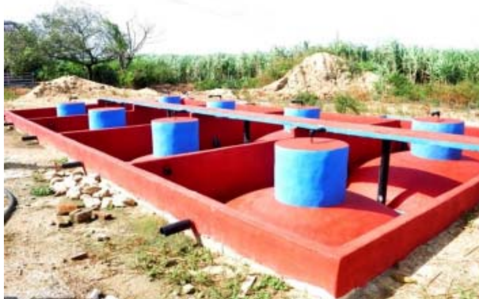
Una inversión de varios miles de pesos han acometido los hermanos Aguilera para instalar el nuevo biodigestor, que procesará los residuales de la producción porcina y la minindustria de conservas.
